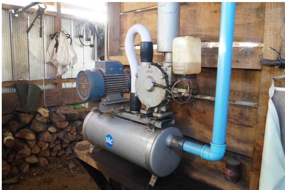
Ilustración 27: Bomba de vacío con acumulador
