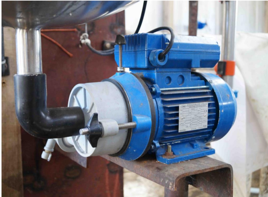
Ilustración 30: Bomba de leche centrífuga sustituida, sin protección
