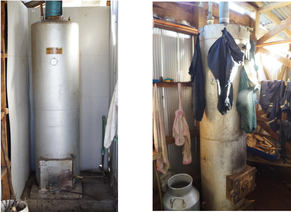
Ilustración 41: equipos termo tanques con capacidad de 200 litros a leña
