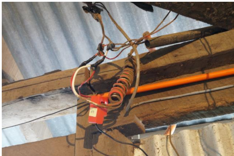
Ilustración 38: Ejemplos conexiones eléctricas inseguras
