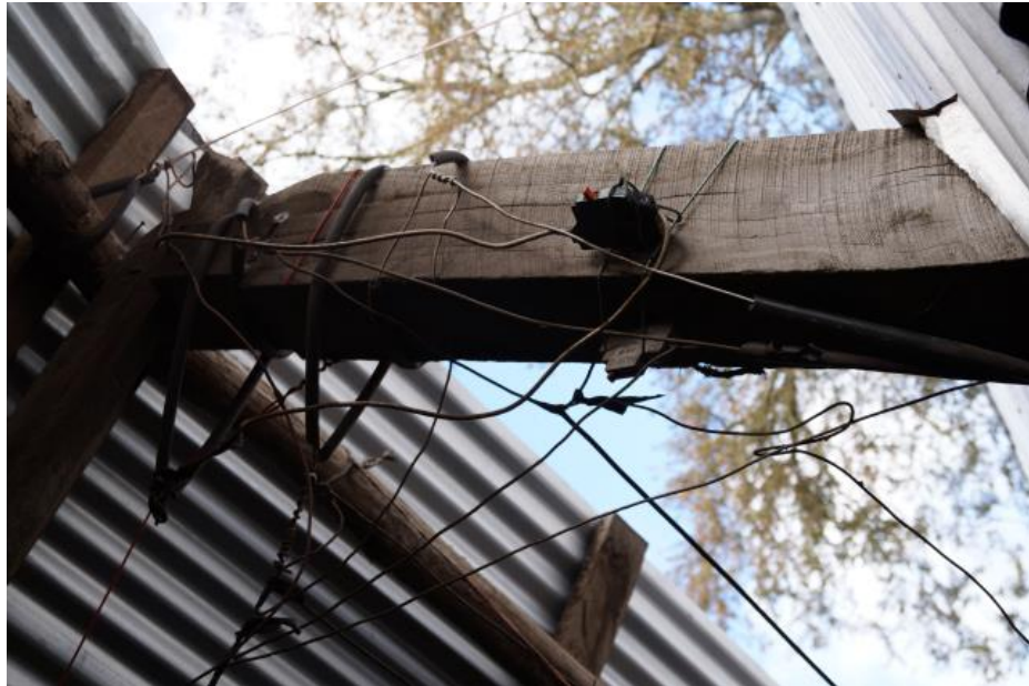
Ilustración 37: Sistemas de corte a la intemperie sin protección
