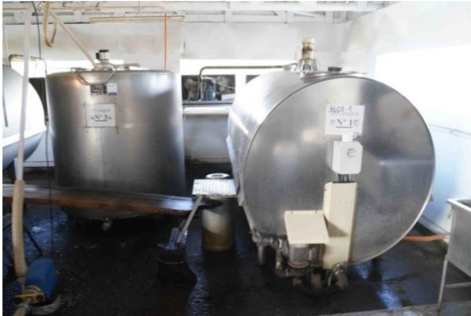
Ilustración 6: Estanques fríos cerrados para almacenamiento de leche
