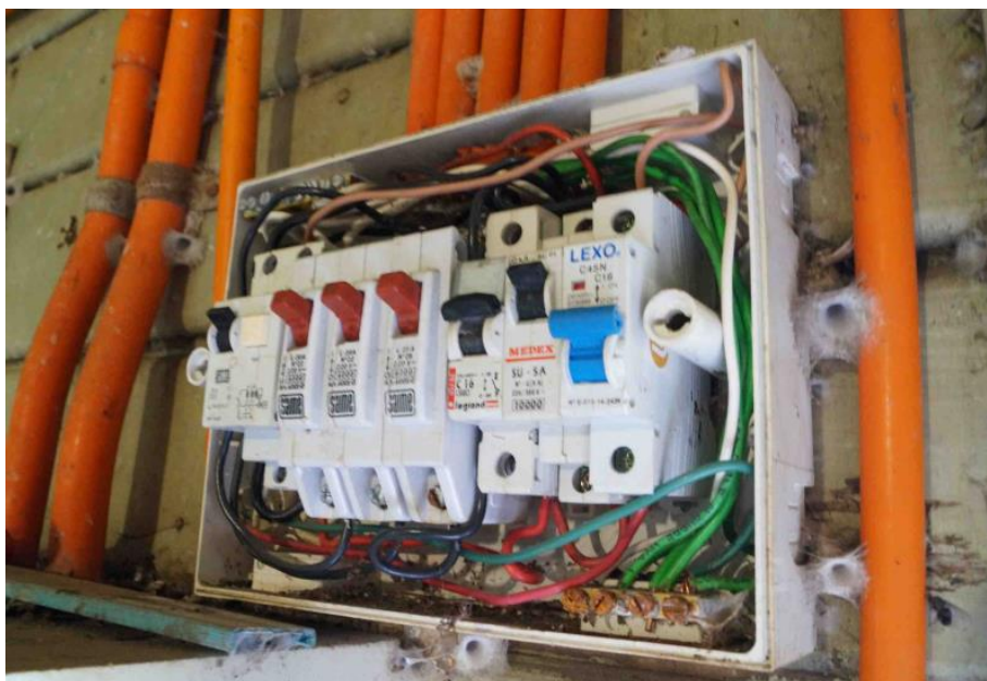
Ilustración 18: Tableros eléctricos sobre cableados.
