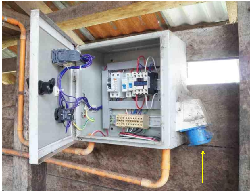
Ilustración 9: Detalle de zona de toma eléctrica para camión recolector
