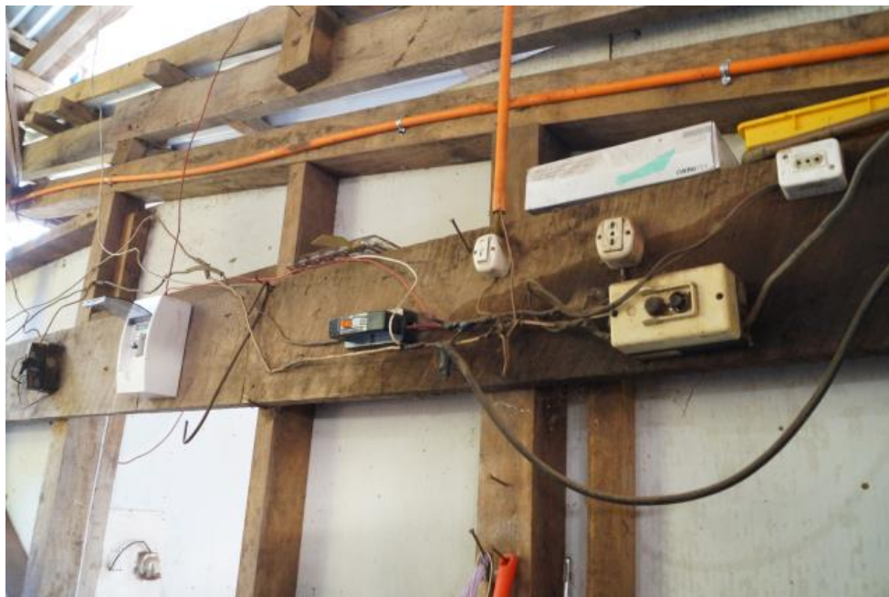
Ilustración 39: Conexiones eléctricas fuera de norma
