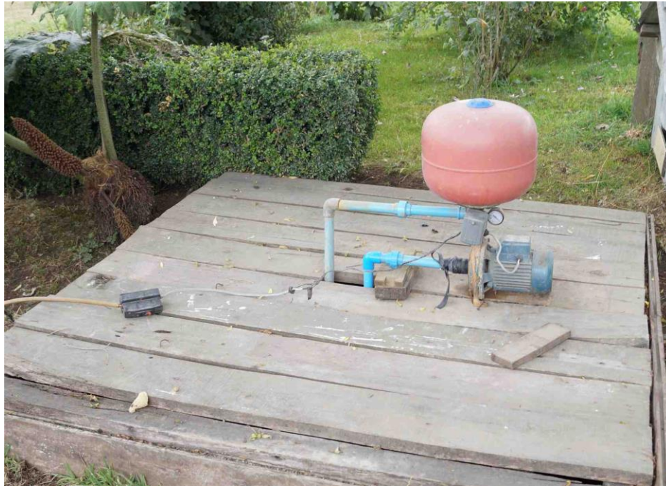
Ilustración 16: Equipos eléctricos y disyuntores a la intemperie sin protección.
