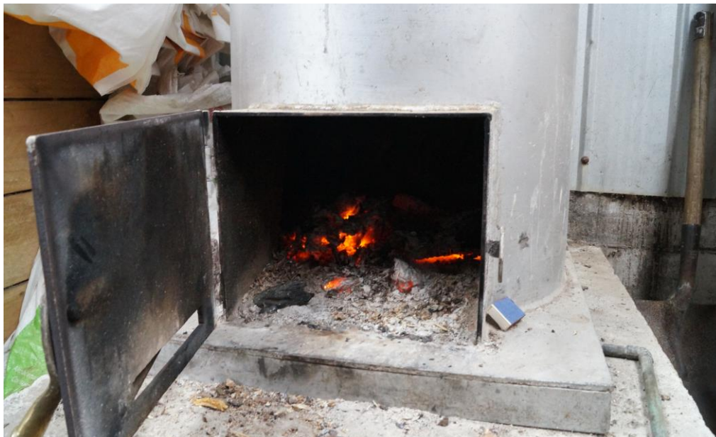
Ilustración 43: Sistema de combustión de leña termo tanques
