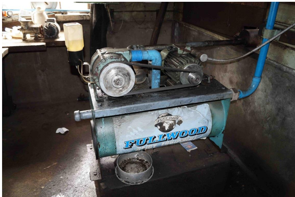
Ilustración 22: Bomba de vacío con motor factor de potencia bajo.
