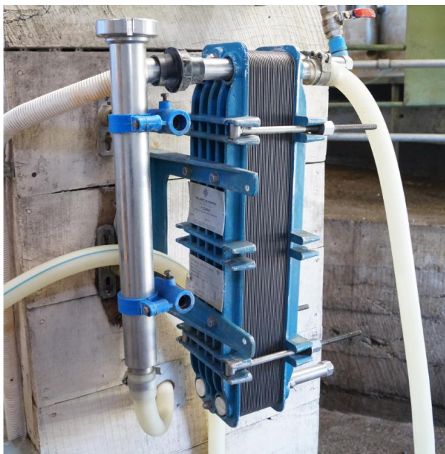
Ilustración 40: Pre enfriador de placas del usuario visitado Erwin Gallardo
