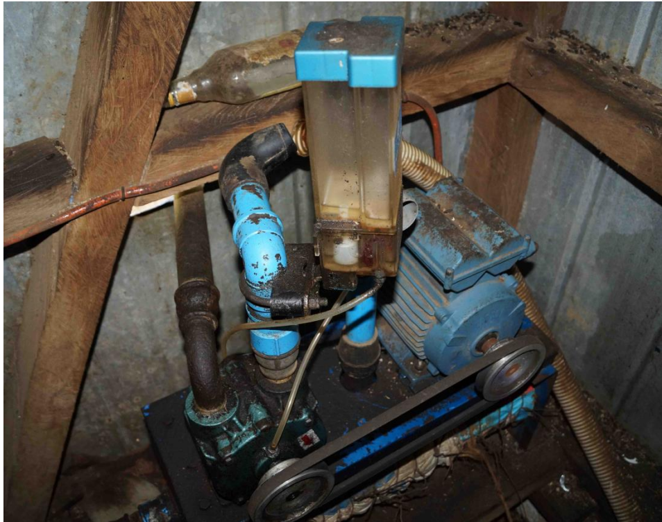
Ilustración 25: Bomba de vacío sin mantención
