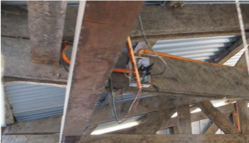
Ilustración 33: Instalación eléctrica deficiente en ambiente saturado de humedad.
