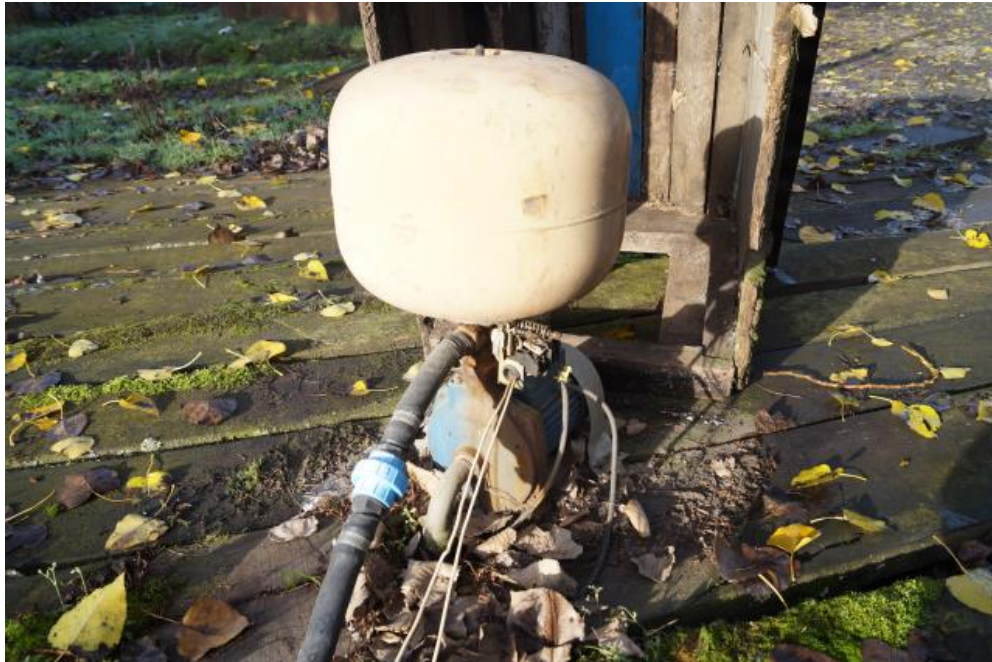
Ilustración 35: Bomba eléctrica a intemperie sin protección
