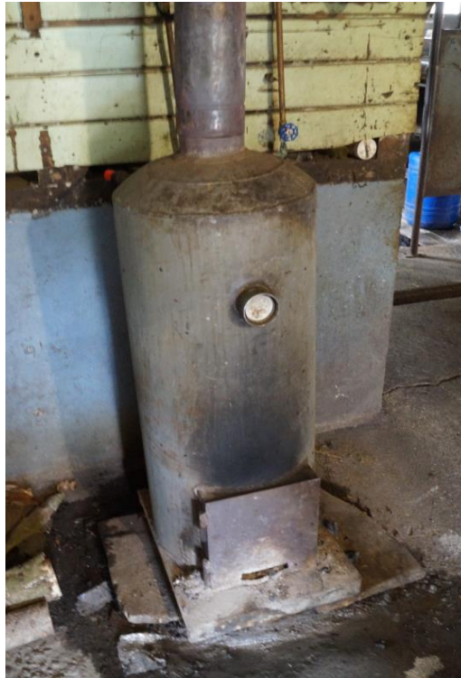
Ilustración 46: Equipo termo tanque con problemas de corrosión y filtraciones
