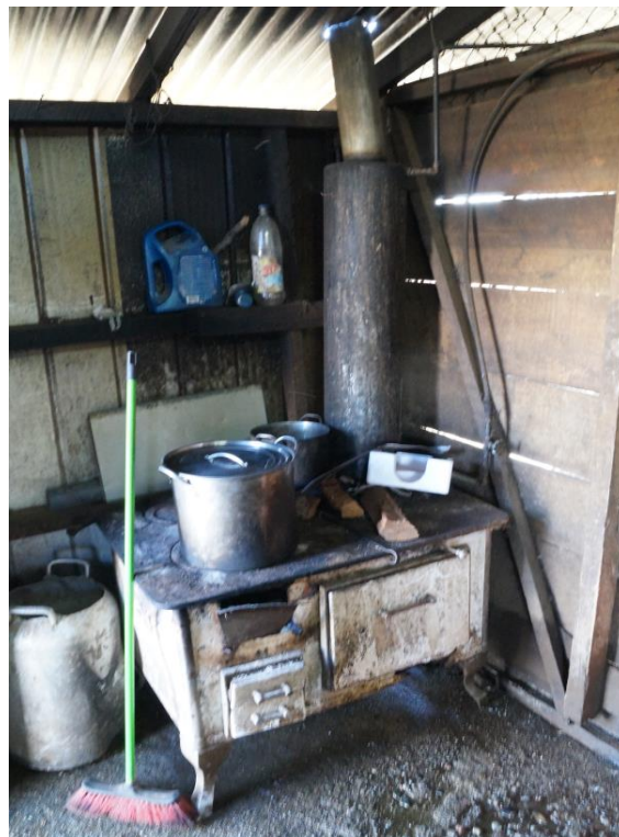
Ilustración 45: Sistema de calentamiento ineficiente y peligroso en su operación
