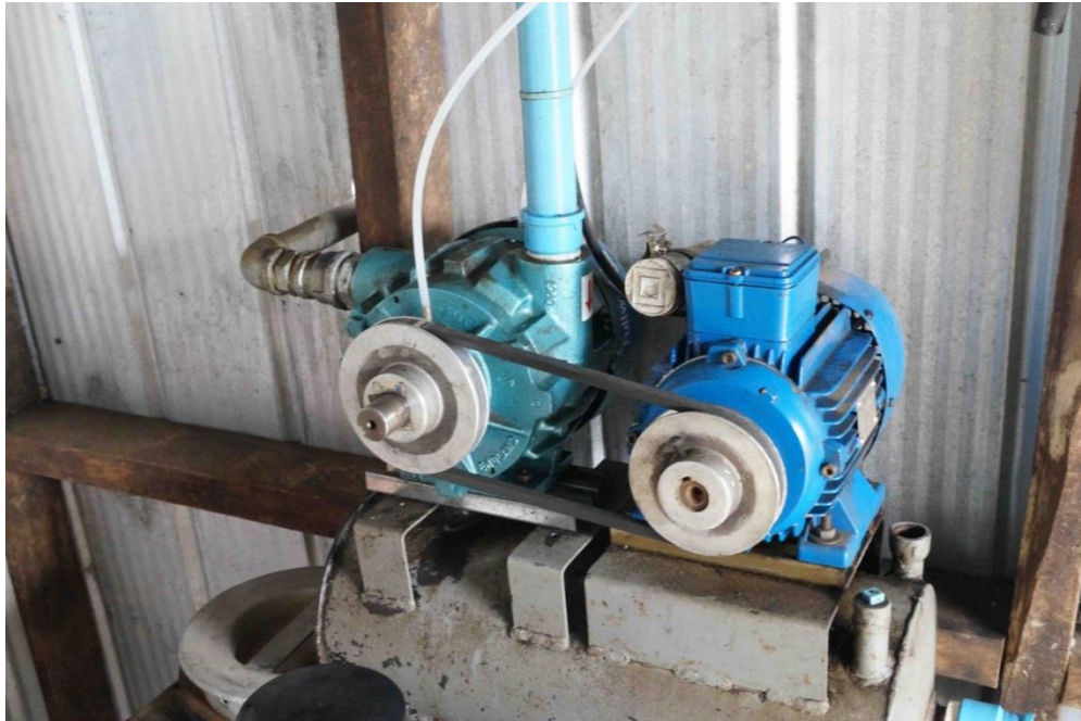
Ilustración 23: Motor bomba de vacío con elevado factor de potencia.
