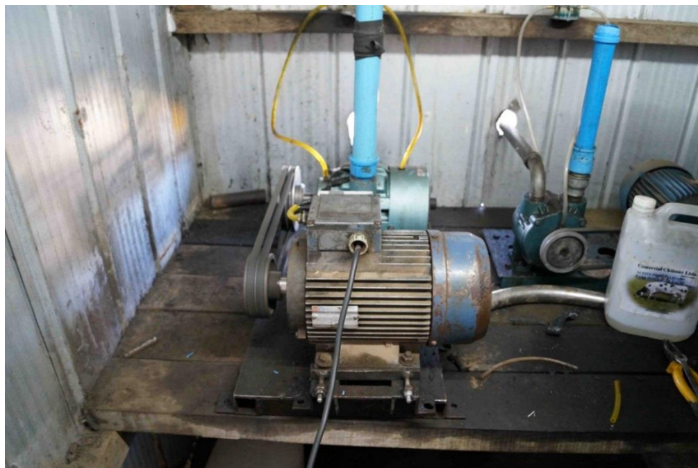
Ilustración 26: Bomba de vacío sin acumulador
