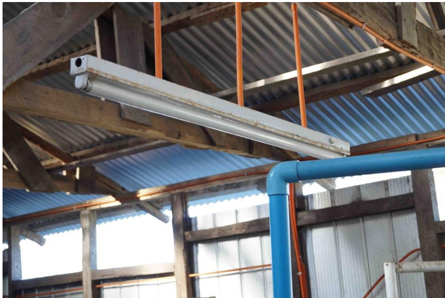
Ilustración 32: Equipo de iluminación T8 sin protección en zona de ordeña
