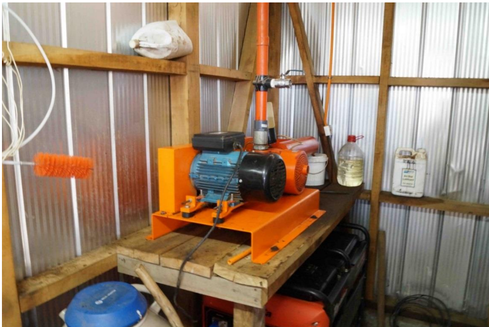
Ilustración 24: Bomba de vacío con mantención
