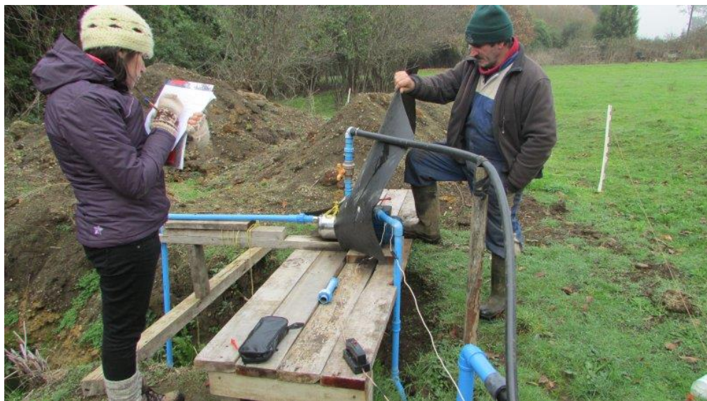
Ilustración 36: Bomba de agua y sistema de corte eléctrico a intemperie.
