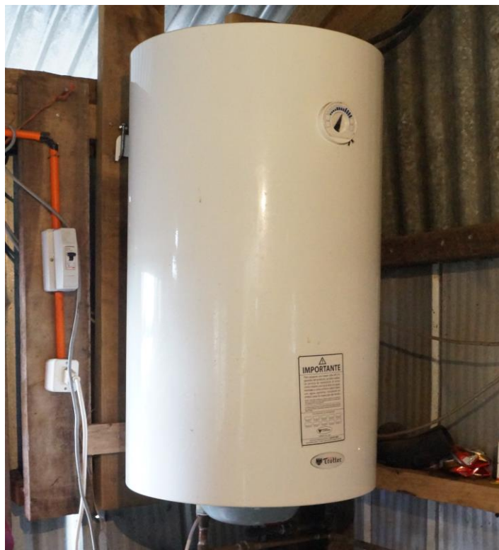
Ilustración 49: Termo eléctrico encendido todo el día sin programación.
