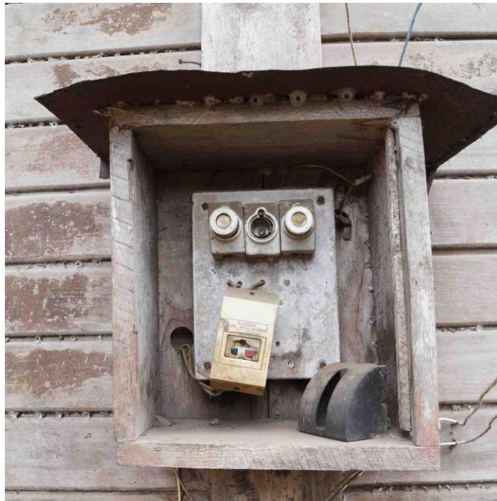
Ilustración 17: Sistemas de protección eléctrica antiguos.
